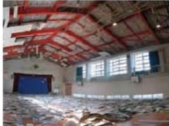
全面的な天井材の脱落
