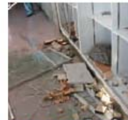
ガラスの破損と収納物の飛び出し
