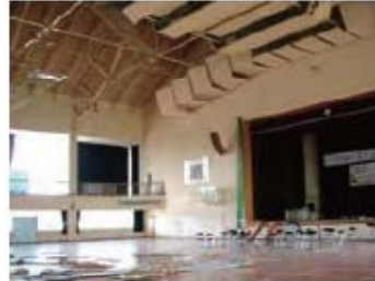
天井材の脱落
