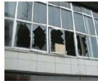
ガラスの破損
