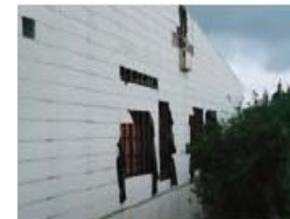
外装材(セメント系)の損傷
