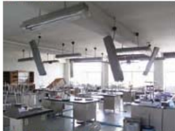
照明器具(特別教室)の脱落
