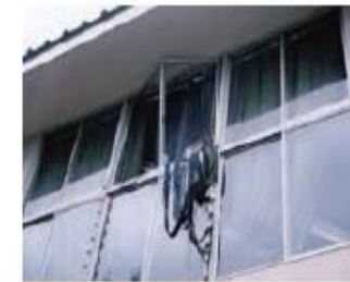
破損の外れた窓のガラス破損
