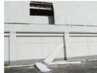
外装材(ALCパネル)の脱落
