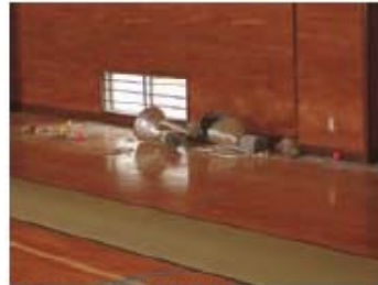
落下した照明器具(屋内運動場)
